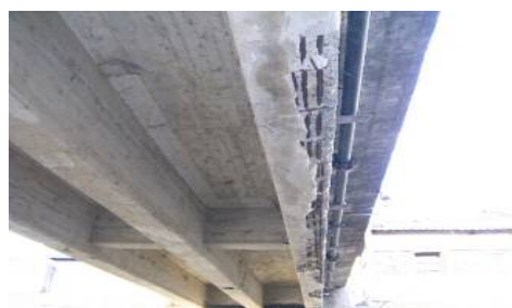
図 1.4 コンクリート橋の損傷状況
