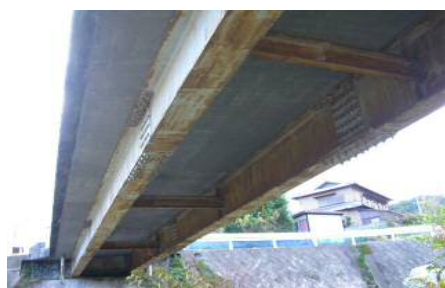
図 1.3 鋼橋の損傷状況
