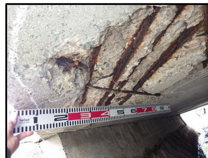
図 1.4 コンクリート橋の損傷状況
