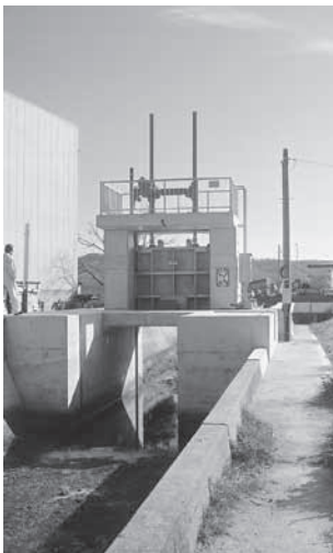
草壁本町の水門 ゲートポンプがつけられる
