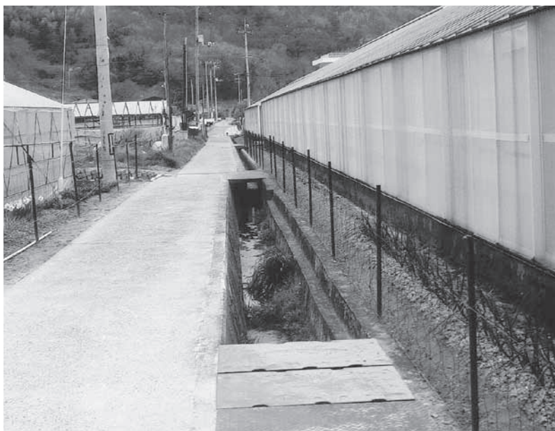
改修が望まれる池田小学校通学路
