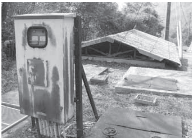
老朽化が進む、かん水設備
