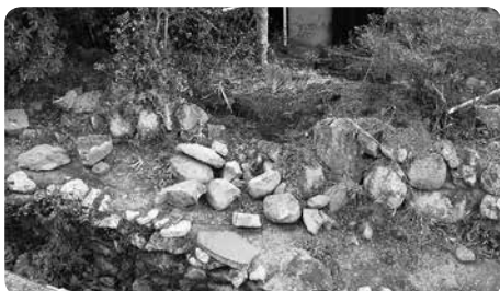
イノシシにより崩された石垣
