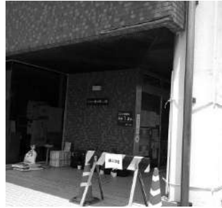
玄関上部の剥がれたタイル
