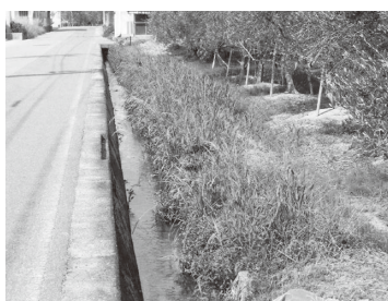
危険な用水路
