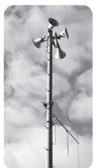
無線 防災施設
