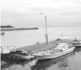
老朽化した浮桟橋
