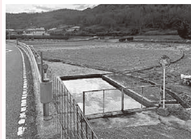
埋まっていた防火水槽
