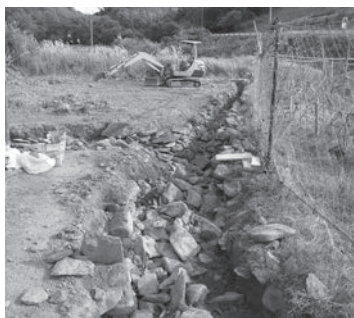
イノシシに壊された水路
